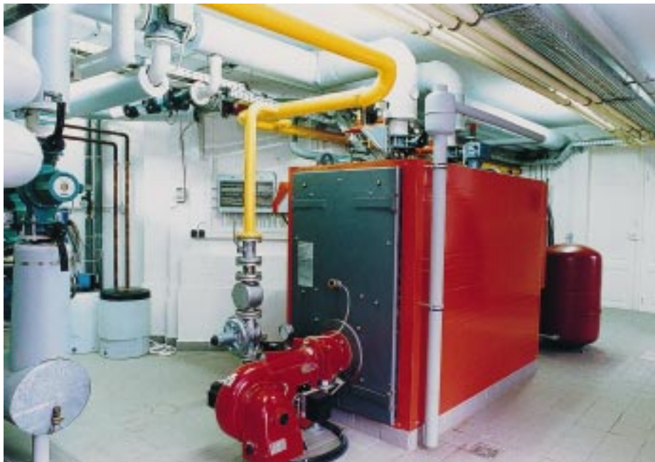
Durch Fernwirktechnik im Heizungsraum und Dienstleistung rund um die Uhr kann Rink im Störfall schnell reagieren
