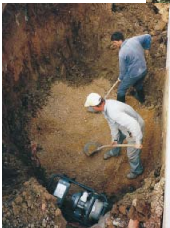
Auf dem Grund der für den Regenwasserbehälter ausgehobenen Baugrube ist ein Sandbett angelegt worden, um eine ebene Auflage zu erzielen
