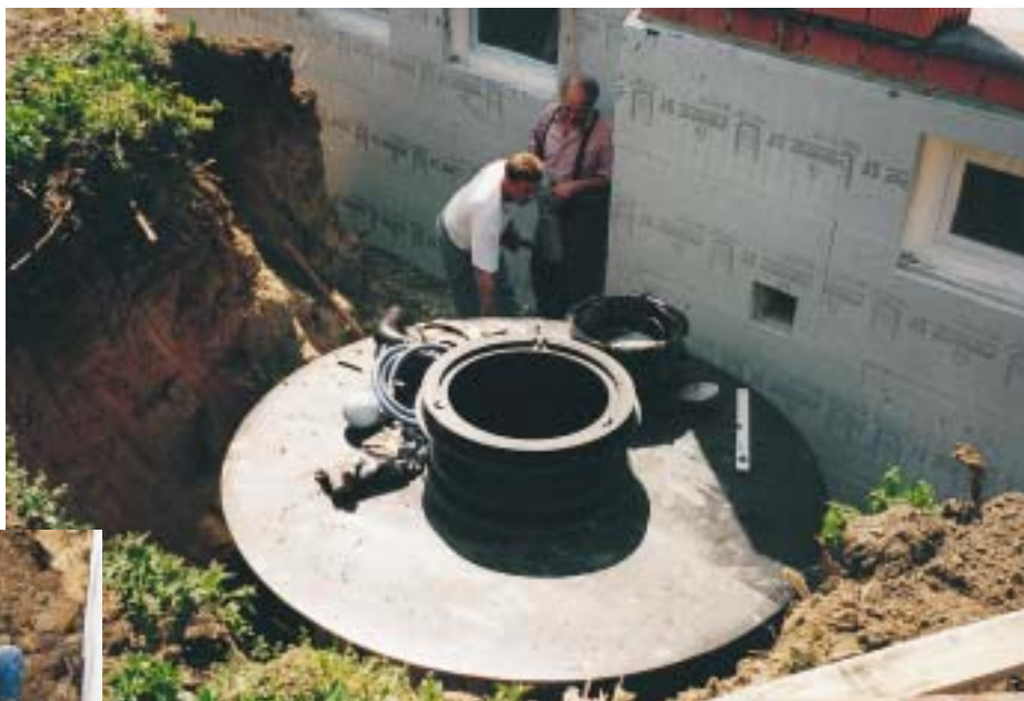
Nachdem der Polyethylen-Behälter in die Grube abgesenkt ist, können die Rohrleitungen angeschlossen werden
