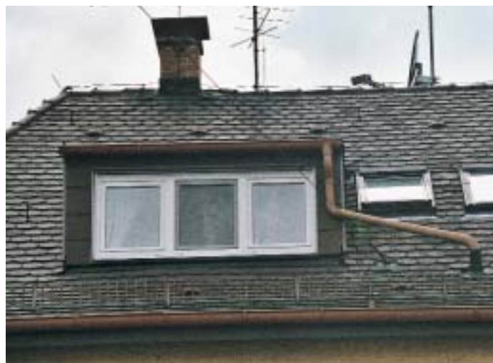
Dachgaubenentwässerung über die Entlüftung eines WC-Fallstranges
