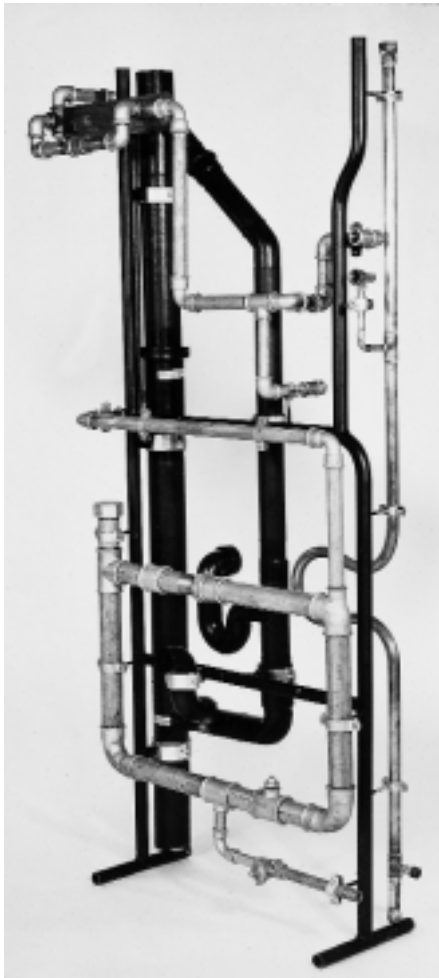
Prüfungswände wie diese, gehören schon seit Jahren zum festen Bestandteil der Meisterprüfung in Stuttgart. Bei der abgebildeten, etwas älteren Wand wurde allerdings die Gasinstallation in verzinkten Rohren und die Trinkwasserrohre in Kupfer ausgeführt.
