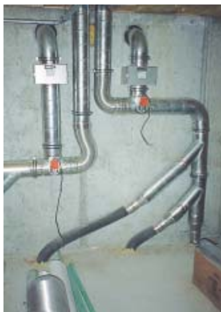
Anschluß des Erdreich-Wärmetauschers (Wärmedämmung wurde später angebracht): oben sind die Filterkästen der Frischluftansaugung sowie die Bypassklappen-Stellmotore (orange) sichtbar
