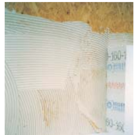
Wärmedämmverbundsystem: 16 cm dicke Platten aus PS-Hartschaum werden mit Kunstharz Dispositionskleber auf die Spanplatten geklebt
