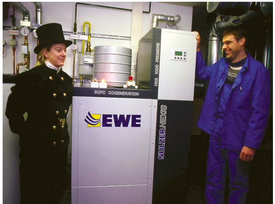
Die Brennstoffzelle erfordert entweder eine enge Kooperationen der Handwerksbetriebe in den Bereichen Elektro, Heizung, Gas und Sanitär oder eine kompetente Besetzung der Gewerke innerhalb eines Betriebes
