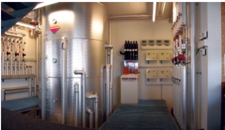
Jedem Besucher frei zugänglich: Die Technikzentrale mit 7,4 m 2 großem Speicher zwischen Empfang und Schulungsraum
