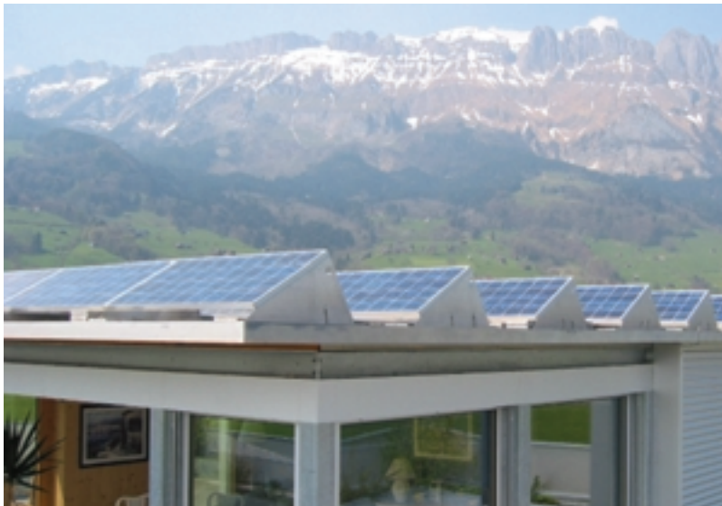
Auf dem Flachdach des Attikageschosses aufgeständerte Photovoltaik-Module
