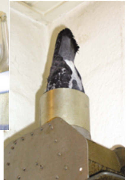
Die Taube im Abgasrohr führte zu einer CO-Vergiftung der Bewohner
