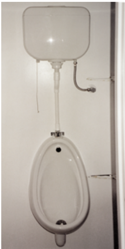
Außergewöhnliche Sanitärinstallation vom „Ende der Welt“
