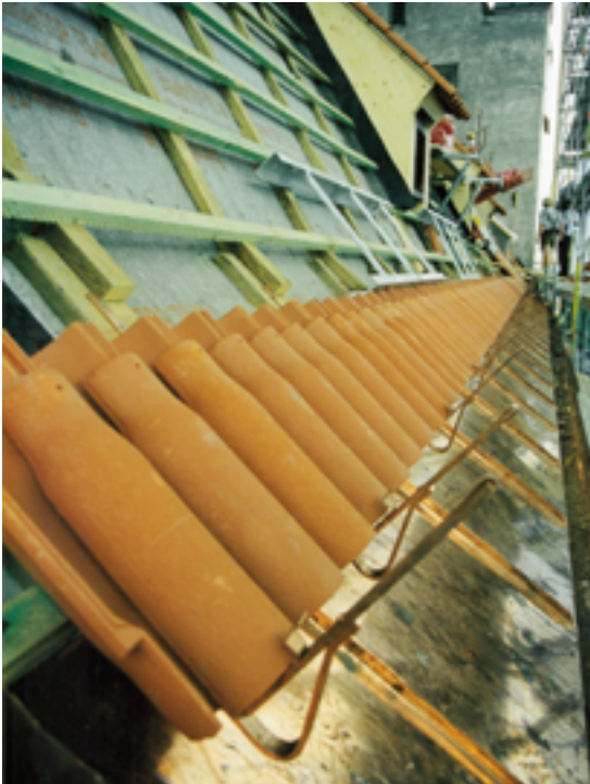
Dank Verwandtschaftserklärung hindert den Klempnermeister nichts mehr, alle möglichen Tätigkeiten für ein Komplettdach anzubieten
