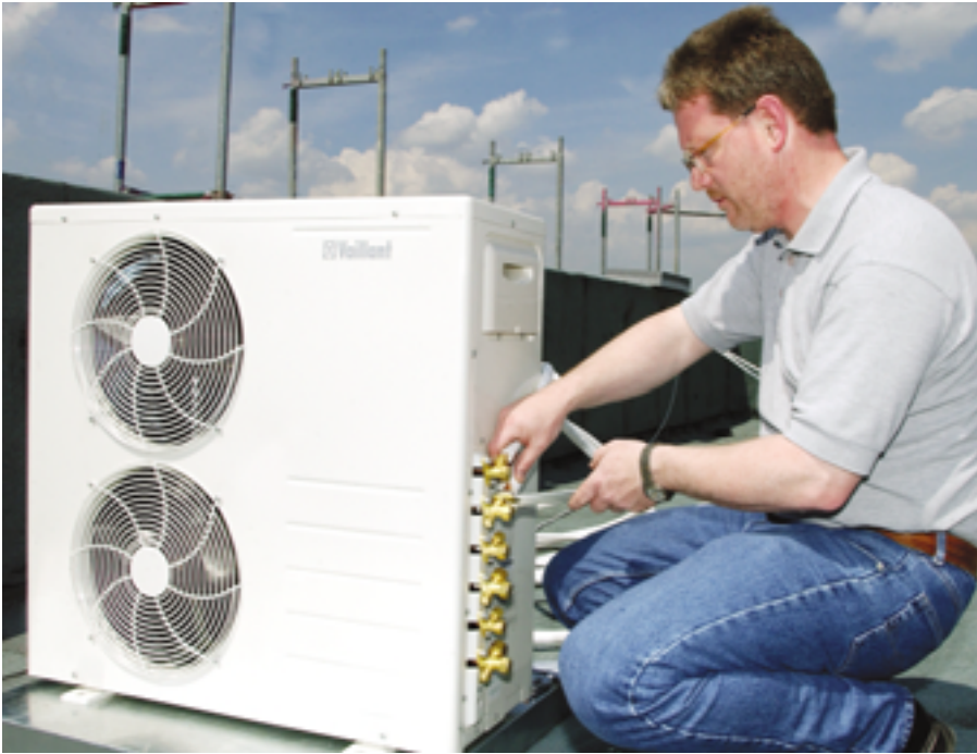
Für Fachhandwerker, die den Markteinstieg testen wollen, bietet Vaillant die Inbetriebnahme von Klimageräten durch den eigenen Servicedienst an
