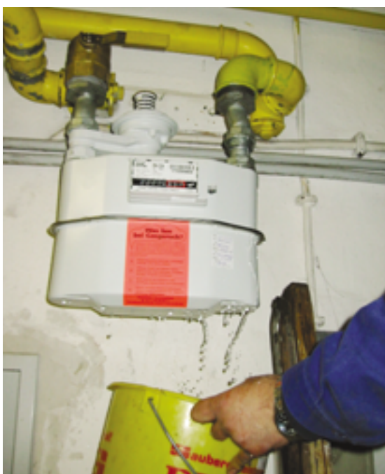
Bild 1 Aus dem Gaszähler strömte Wasser
