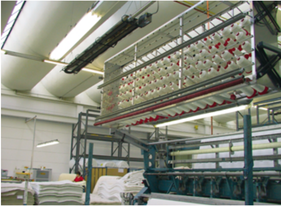
Dunkelstrahler eignen sich für Bereiche, bei denen keine Zugluft entstehen darf und wo unterschiedliche Temperaturzonen zu regeln sind (hier: Textilizuliefererbetrieb Neu-Textil)
