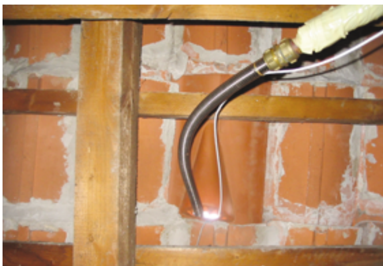
Bild 7 Erhöhte Wärmeverluste III: Fehlende bzw. nicht fachgerechte Dämmung der Solarkreisverrohrung
