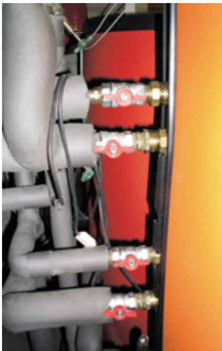
Bild 5 Erhöhte Wärmeverluste I: Fehlende Wärmedämmung an den Speicheranschlüssen
