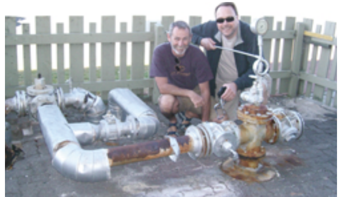
In Rotorua pumpen viele Häuser die Wärme direkt aus der Erde. Diese Pumpstation entdeckte Dietmar Busch direkt vor unserem Hotel. Anschließend wird das Wasser über Schluckbrunnen wieder der Natur zugeführt
