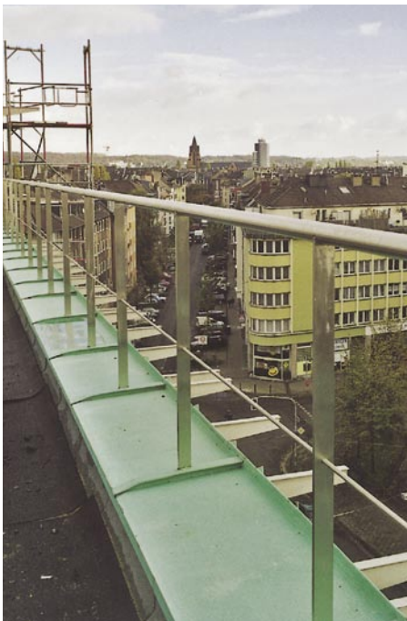
Mauer- und Attika-Abdeckungen sind charakteristische Beispiele für geklebte metallische Bauteile, die der Witterung in besonderem Maße ausgesetzt sind
