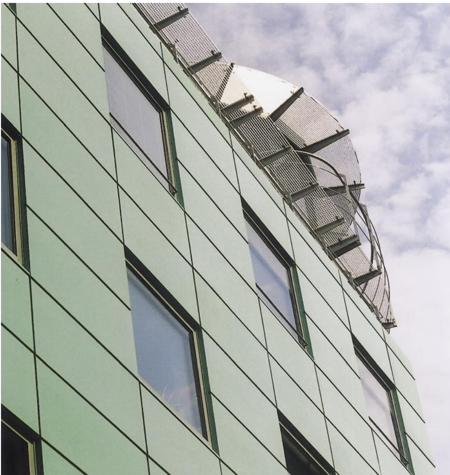
Aber auch das moderne Bauen bedient sich der fortschrittlichen Klebtechnik, wie beispielsweise bei der Ausführung dieser vorgehängten Fassade
