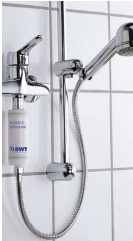
Bild 11 Bei einer massiven Legionellen-Kontamination können gefährdete Entnahmestellen mit Endstrang-Filter abgesichert werden
