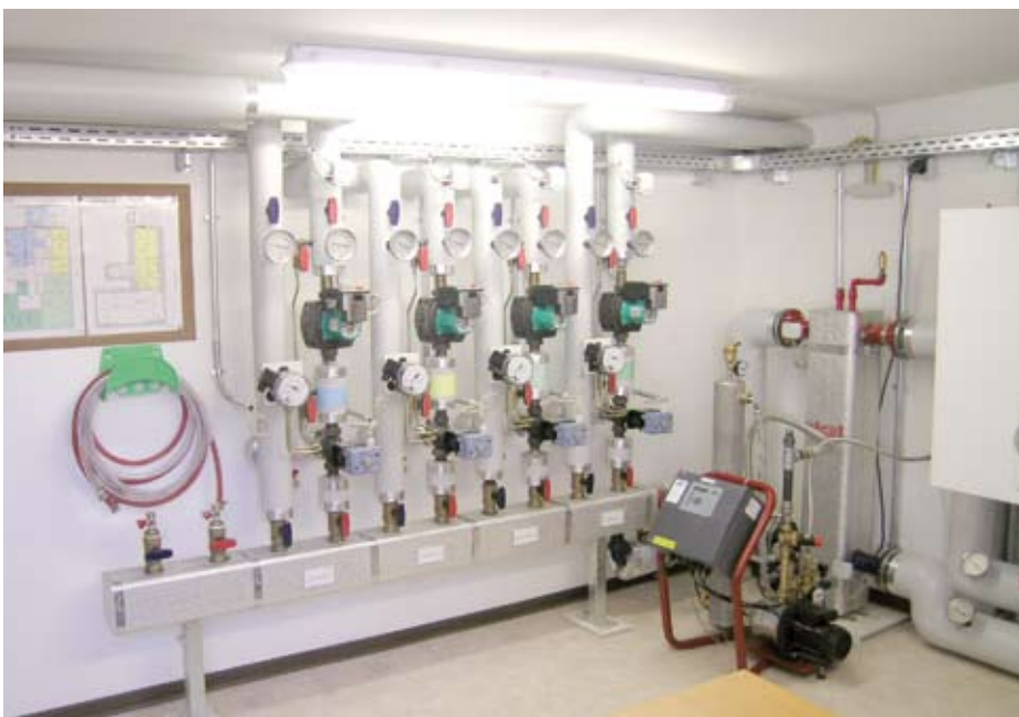
Blick auf den Verteiler sowie (rechts davon) auf die hydraulische Weiche und die Entgasungsstation
