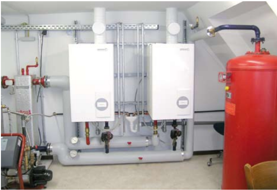
Wenig Kessel für insgesamt 140 kW Leistung: Die Heizungsanlage ist einem kleinen Dachraum untergebracht
