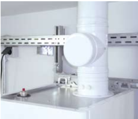
Der Kondensatablauf befindet sich zwischen den beiden Kesseln
