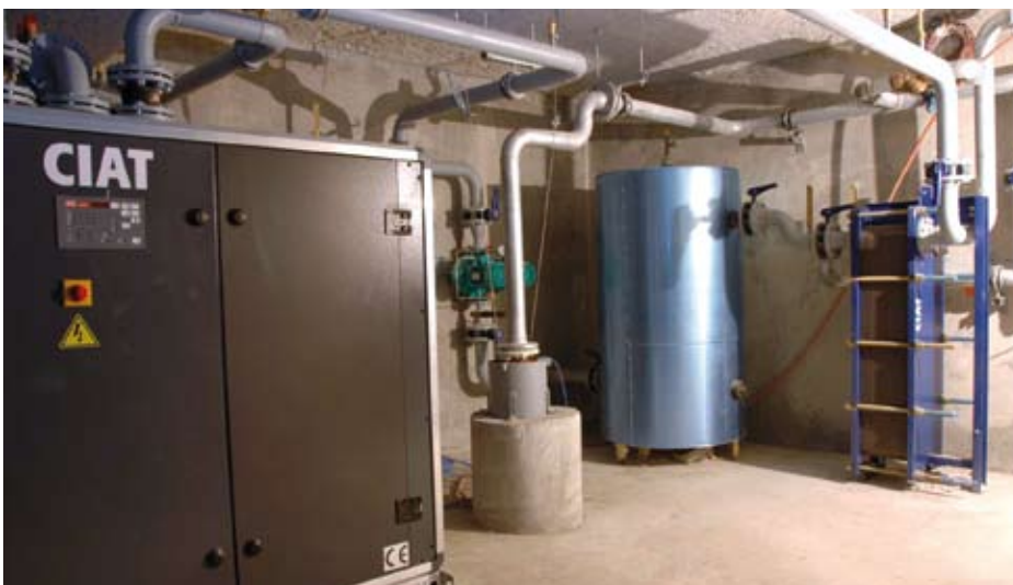
Zentrale Installation des Kaltwassererzeugers/Wärmepumpe im Technikraum eines Appartementgebäudes
