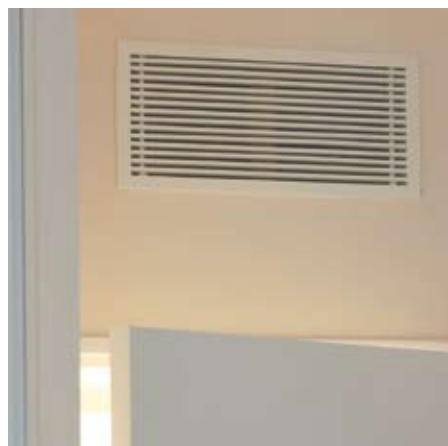
Durch kombinierte Luftein- und -auslässe gelangt aufbereitete Luft in die Räume bzw. wird verbrauchte Luft abgeführt
