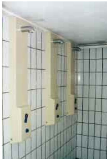
Bild 4 In den Duschen des Sportheims Wendelsheim mußte nach Einbau eines physikalischen Wasserbehandlungsgerätes 1989 kein Duschkopf mehr entkalkt werden. Zuvor war dies bei einer Gesamthärte von 19 °dH etwa jede Woche erforderlich gewesen
