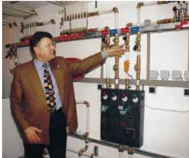
Dieser UG-Raum eines Wohnhauses auf dem Firmengelände wurde als praktischer „Show-Room“ für die in die Heizungs- und Trinkwasserleitungen eingebauten Oventrop-Produkte eingerichtet (im Bild: Marketingleiter Werner Dickmann)
