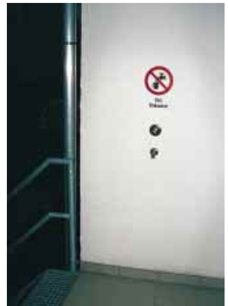
Bild 3 Entnahmestelle für Regenwasser am Gebäude der Stadtwerke Zweibrücken (Wasserversorger) mit doppelter Kennzeichnung
