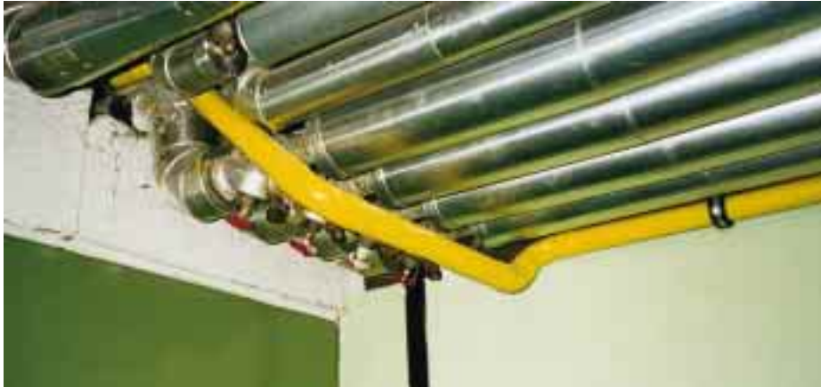
Bild 9 Die beste Befestigung nach TRGI ist chancenlos, wenn im Brandfall einige hundert Kilogramm schwere Bauteile auf die Gasleitung stürzen
