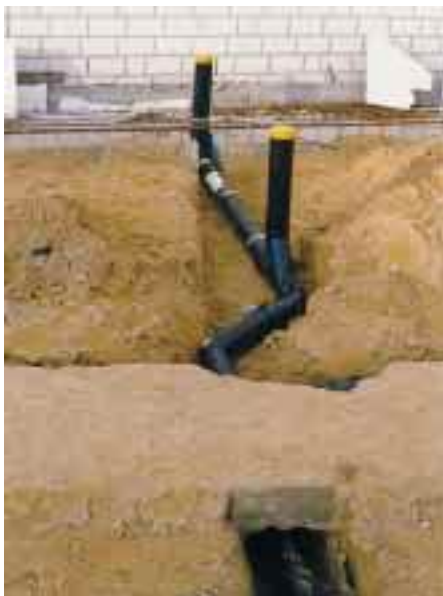
Die Flexibilität des Rohrsystems war bei einer bauseitsbedingten Änderung der geplanten Leitungsführung von Vorteil
