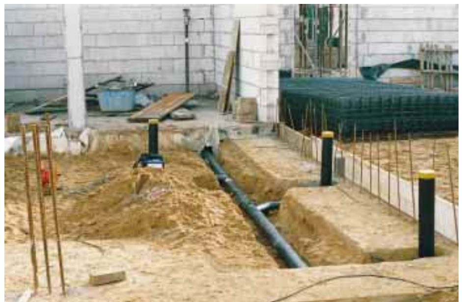
Unkontrollierte Setzungen des Erdreiches erfordern flexible und bruchsichere Rohre
