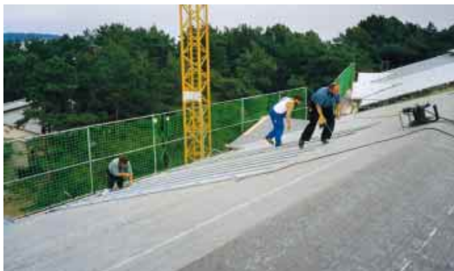
Nach dem Verlegen und Befestigen der Scharen und dem Schließen der Traufe wurden die Falze mit zwei Universalfalzmaschinen zugefahren
