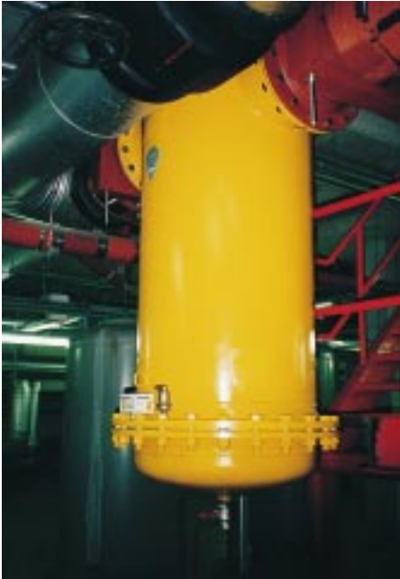
In der Universitätsklinik Utrecht installierter Spirovent Schlamm Hi-flow Demontabel DN 400 in Flanschausführung mit 1/2"-Spirotop-Schnellentlüfter zum Größenvergleich
