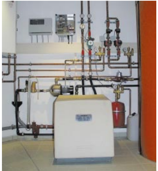
... sowie die Wärmepumpe von Siemens, bei der eine 55 m tiefe Erdsonde als Wärmequelle dient
