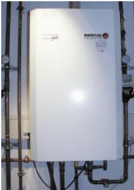
Im Grundriß noch nicht eingetragen, doch in der Zwischenzeit bereits installiert: Der Gasbrennwertkessel von Brötje ...
