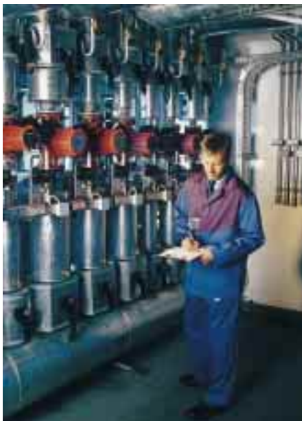
Auch immer komplexere Anlagentechniken erfordern eine ständige Weiterentwicklung der SHK-Handwerker
