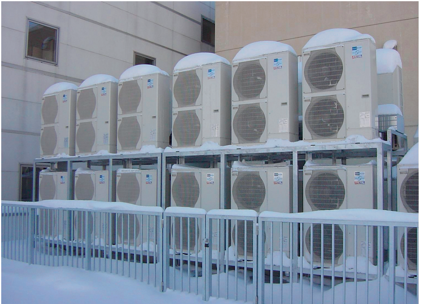
Abbildung 1.6 Gewerblicher Einsatz bei tiefen Außentemperaturen mit Zubadan-Technologie
